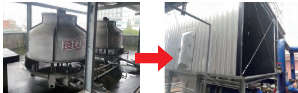
逆流式冷卻水塔
